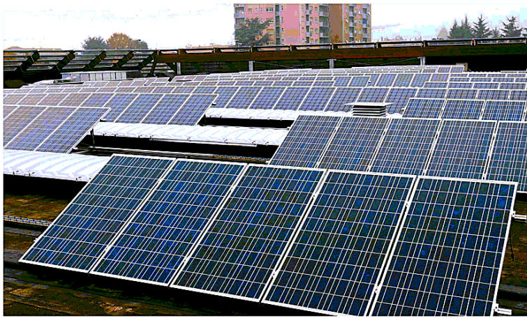
Un tetto ricoperto da pannelli fotovoltaici. Presto molte strutture pubbliche potrebbero aumentare gli impianti di questo tipo (Ftg)
